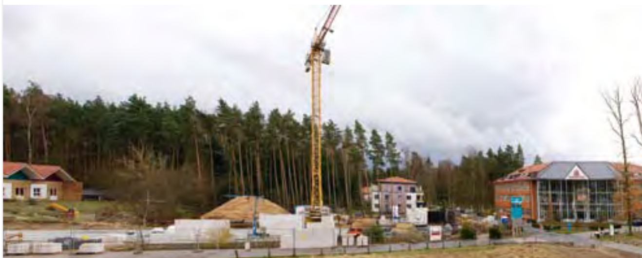
März 2008: Die Bauarbeiten für den Erweiterungsbau der Parkklinik für die Orthopädie der Brandenburg Klinik sind in vollem Gange.
